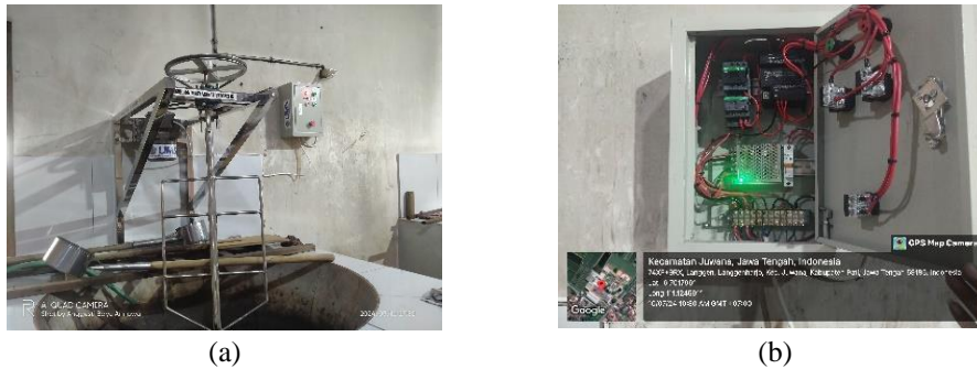
Gambar 9. Instalasi alat pengaduk pada tungku pemasakan bahan kecap: (a) Tampilan alat lengkap; (b) Tampilan isi panel pengendalian alat.
